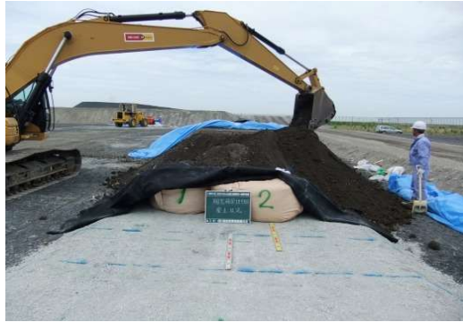
東京都環境整備公社焼却飛灰8,000Bq/kg 一時保管計画策定及び実施業務
